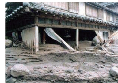
土石流被害を受けた家屋 国土交通省九州地方整備局雲仙復興事務所提供
